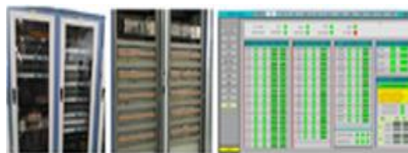
图 5.2 SXFEL 设备安装与控制界面示例
