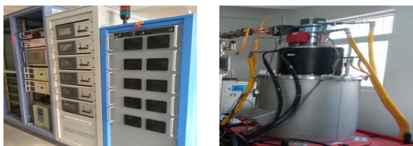
图 1 核能调制器布局及脉冲变压器油缸组件
